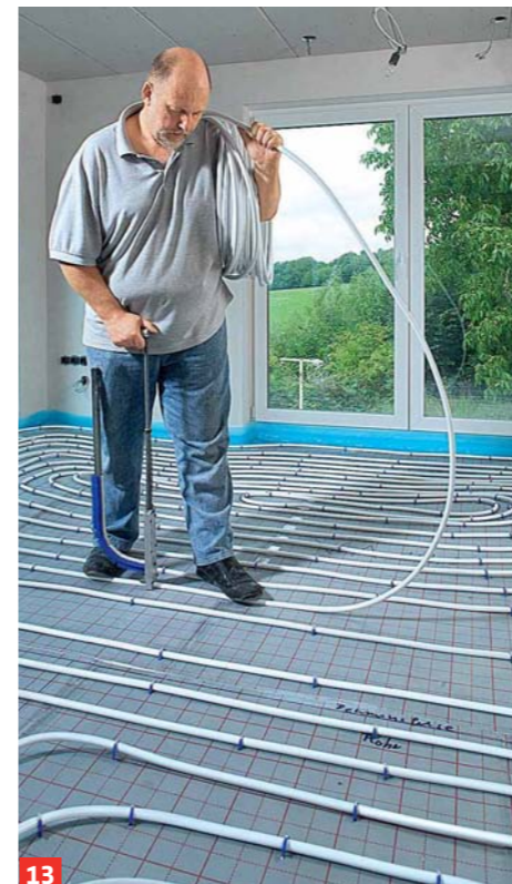
13 Die auf den Dämmplatten aufgedruckte Rasterung hilft, die Heizrohre gleichmäßig zu verlegen. Die Rohre werden im ...
