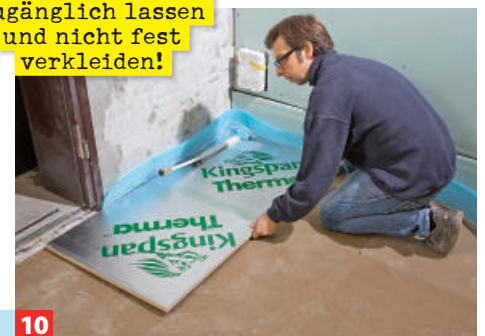
10 Um den Boden gegen Kellerkälte zu dämmen, verlegte der Bauherr Polyurethanplatten in 20 mm Stärke.
