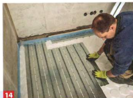
14 ... einfach in der nächsten Reihe einsetzen, so bleibt kein Verschnitt übrig. Verlegen Sie die Bleche nahezu vollflächig im Raum, ...
