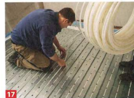
17 ... Rohr schieben und mit Mutter am Verteiler verschrauben. Das Rohr sauber von der Rolle ziehen und in die Aussparungen ...
